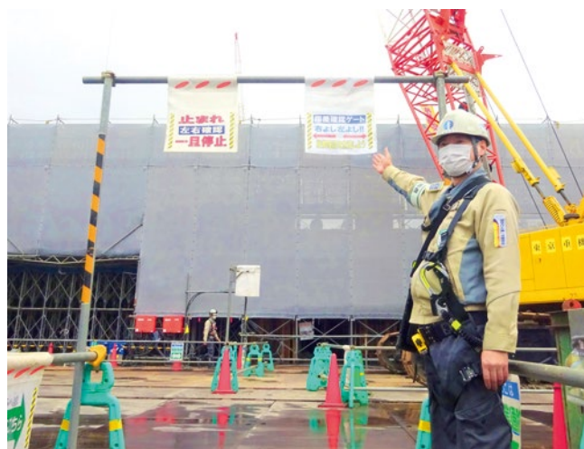
指差し確認ゲートを設けて安全意識の定着を図っている
