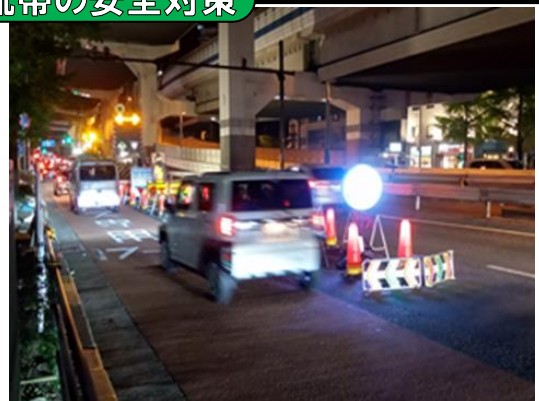
導流帯の開始部に 高輝度のLED照明を設置
