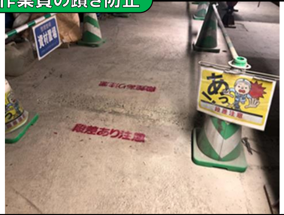
段差部に注意喚起表示
