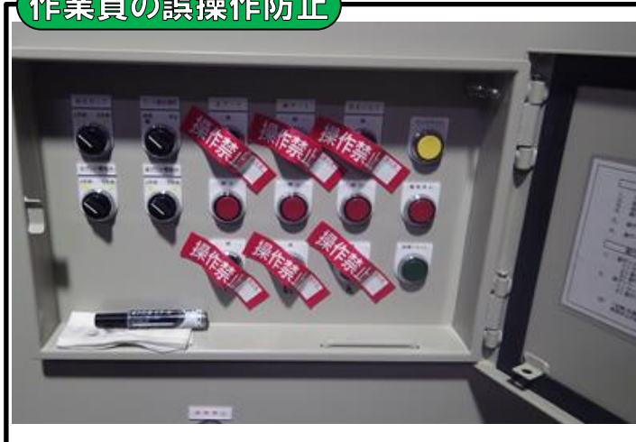
点検中の誤操作防止の取組
