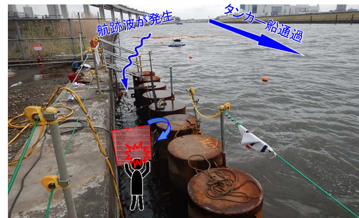
事故発生状況
