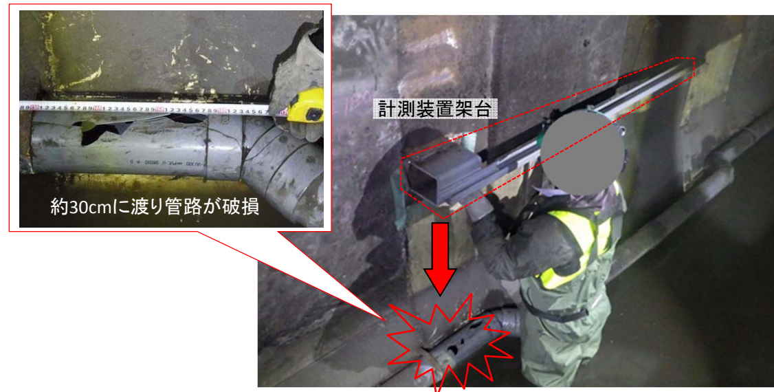
事故発生状況再現・排水管損傷状況
