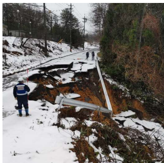
道路被害状況の調査
