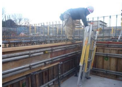
足場を下ろしたところ、バランスを崩す
