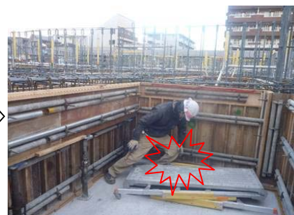
型枠上から落下し負傷
