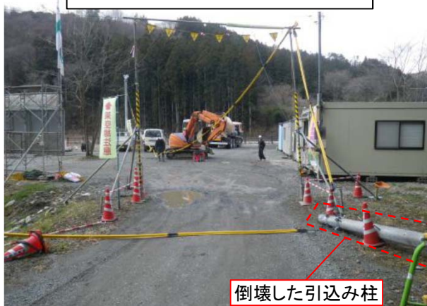
架空線・引込み柱 損傷状況
